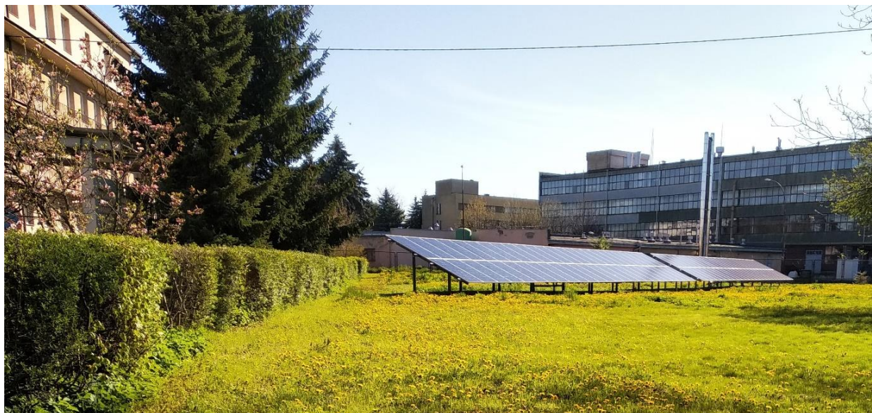
Fotografia 9. Instalacja fotowoltaiczna przy budynku ZOL w Przemyśle
